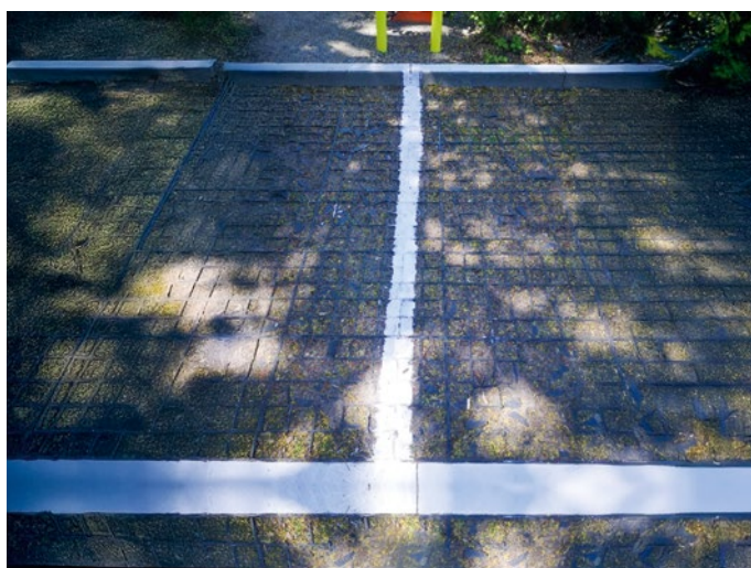
Rys. 4. Niewłaściwe oznaczenie i usytuowanie miejsc stacji ładowania
